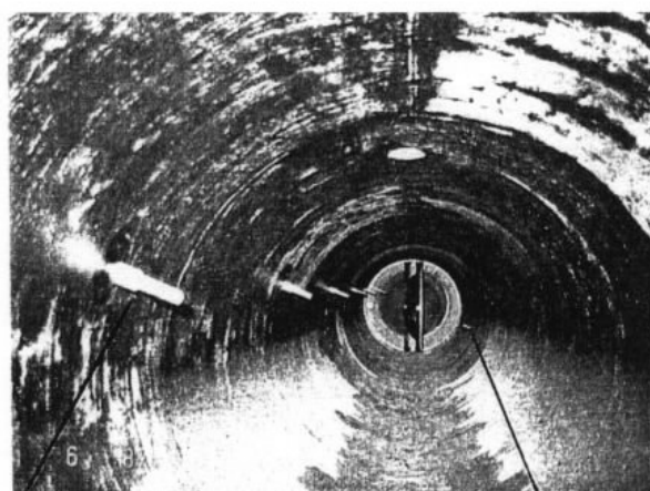
照片 4 冷卻海水管路
